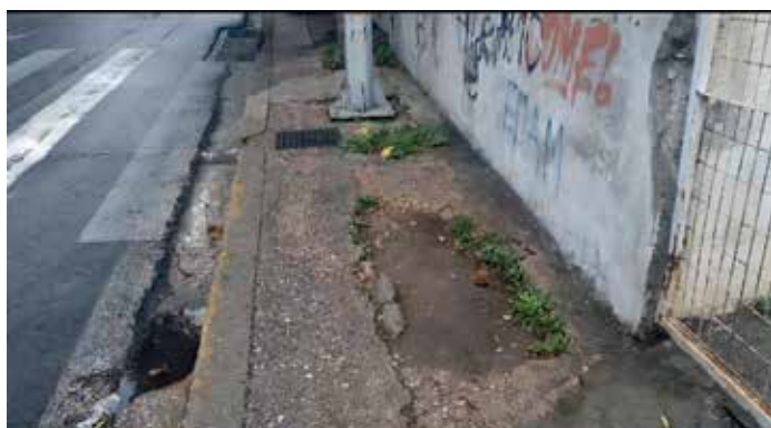
Σε κακή κατάσταση τα πεζοδρόμια της οδού Νικ. Φλώρου, πλησίον των σχολικών μονάδων
