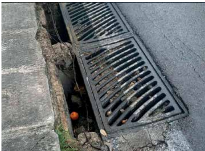
Σπασμένα και βουλωμένα φρεάτια (Οδός Νικολάου Φλώρου)
