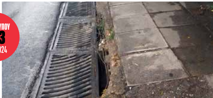
Επικίνδυνες τρύπες πλησίον του 107 ου Δημοτικού Σχολείου (Οδός Νικολάου Φλώρου)
